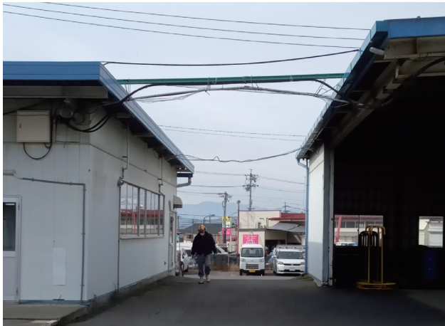
お客様先の不安全箇所改善事例(お客様構内の電線緩みの解消)
