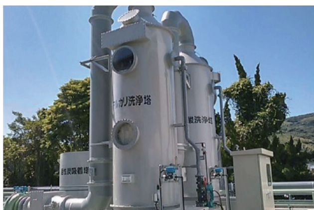
高い脱臭率が得られるスクラバー方式の脱臭装置(ダイセキ九州事業所)
