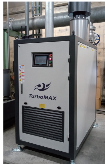
活性汚泥施設のターボブロワ (ダイセキ関東事業所)
