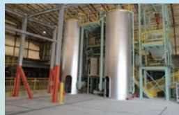
建設汚泥の中間処理
