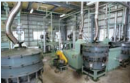
廃油処理 (振動ふるい機)
