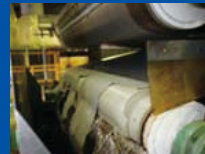
金属回収装置
