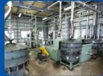
廃油処理(振動ふるい機)
