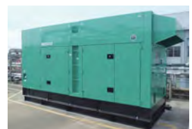
移動式発電機
