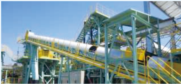
弥富リサイクルセンター 洗浄処理施設
