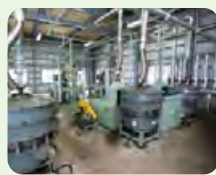
廃油処理 (振動ふるい機)
