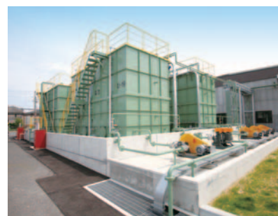
熱を持っている製品保管タンクと、加熱が必要な原料の保管タンクとを交互に配置することで、省エネ化を実現
