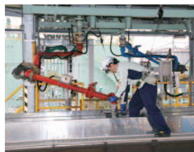
製品を積み込むタンクローリー充填所では、作業 者の転落を防止するため、安全帯を掛けられる 親綱を設置
