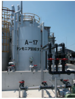
アンモニア回収装置
