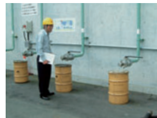
配管下の受け容器(関西事業所)
