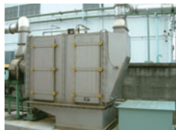
脱臭装置(名古屋事業所)
