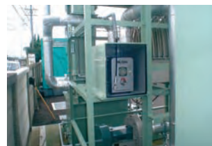
オゾン脱臭装置 (エコエネルギーセンター)
