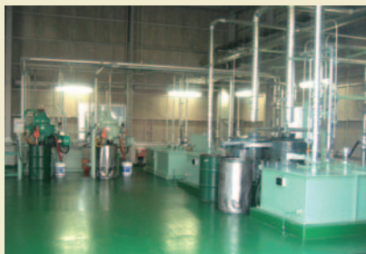
再生重油製造設備
