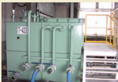
補助燃料ブレンドタンク
