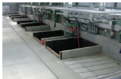
屋内に設置された汚泥受入施設 (関東事業所)
