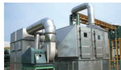
活性炭吸着装置 (名古屋事業所リサイクルセンター)
