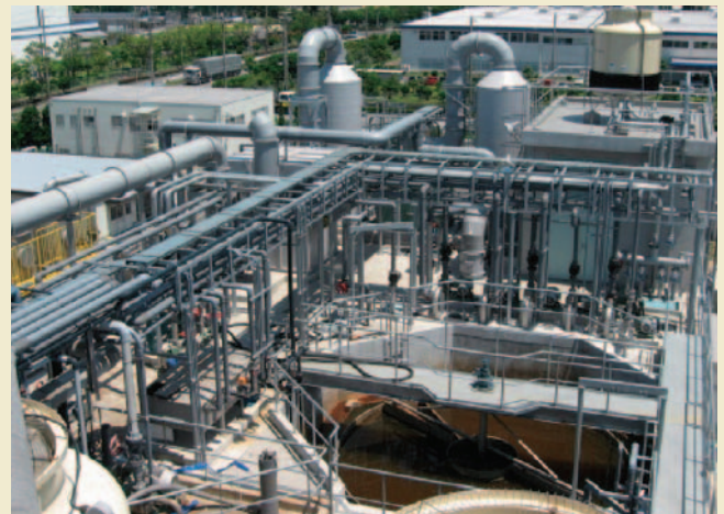
新水処理施設
