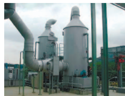
スクラバー式脱臭装置 (関東事業所)
