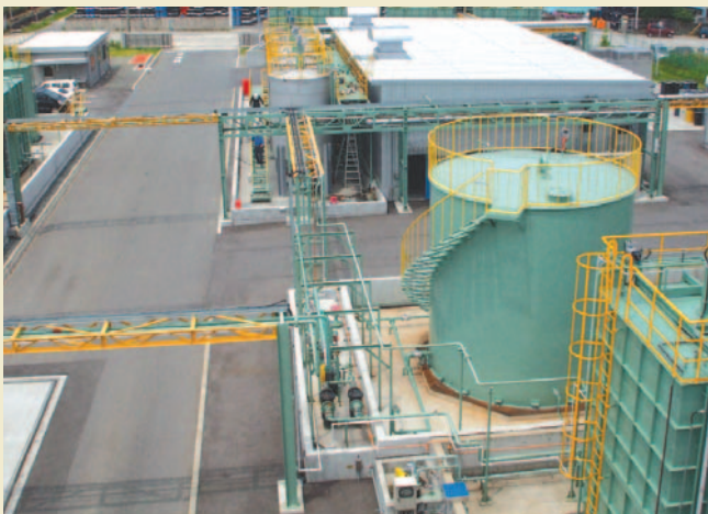
リサイクルセンター燃料施設
