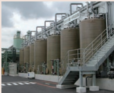
油水分離・中和設備
