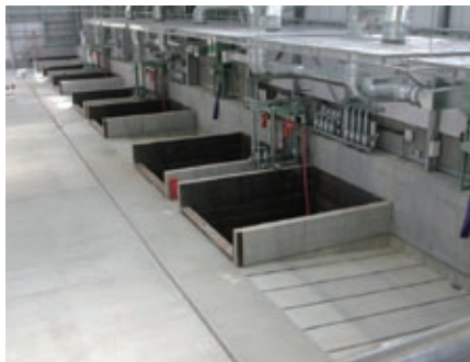
屋内に設置された汚泥受入施設（関東事業所 新工場）
