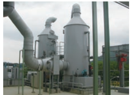
スクラバー式脱臭装置（関東事業所 新工場）
