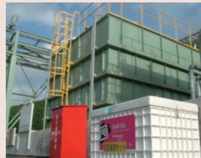
漏洩対策キット設置状況
