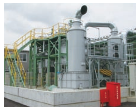
新設脱臭装置(関東事業所 新工場)
