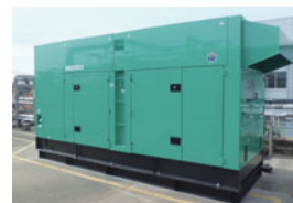
移動式発電機
